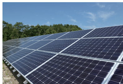
太陽光パネル
